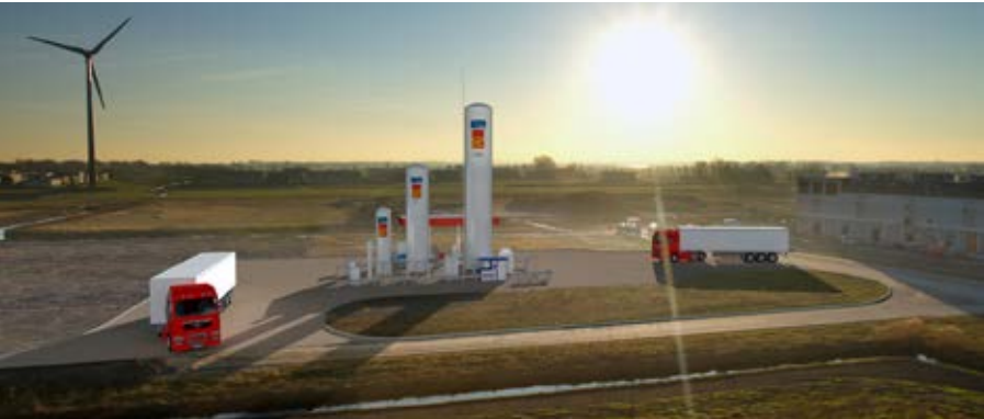
(bio-) LNG station
